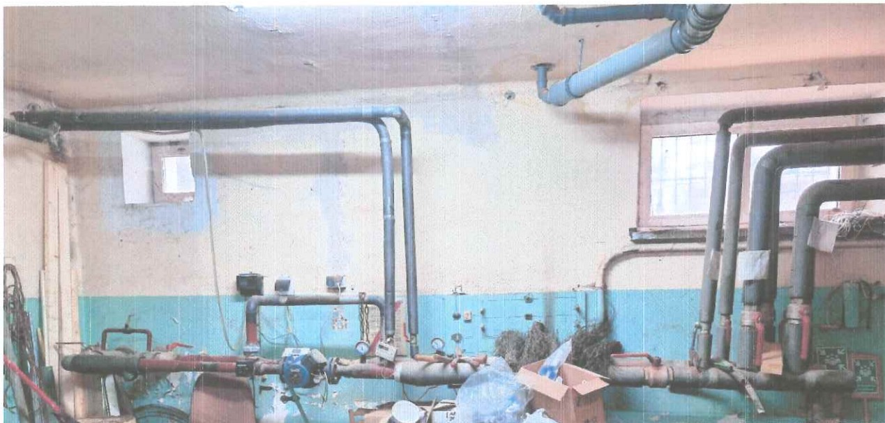
Zdjęcie 15. Węzeł cieplny.
