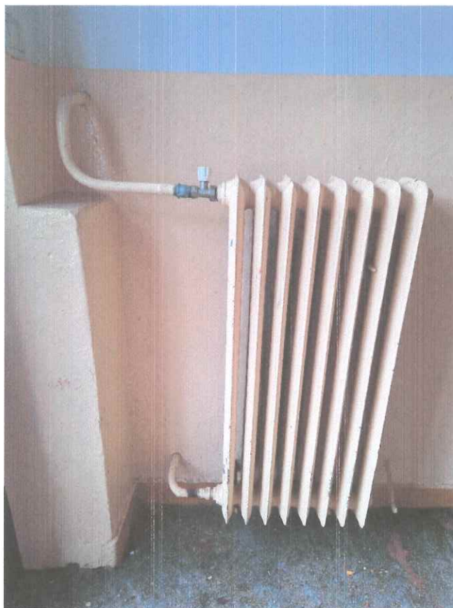
Zdjęcie 13. Grzejnik w budynku szkoły.
